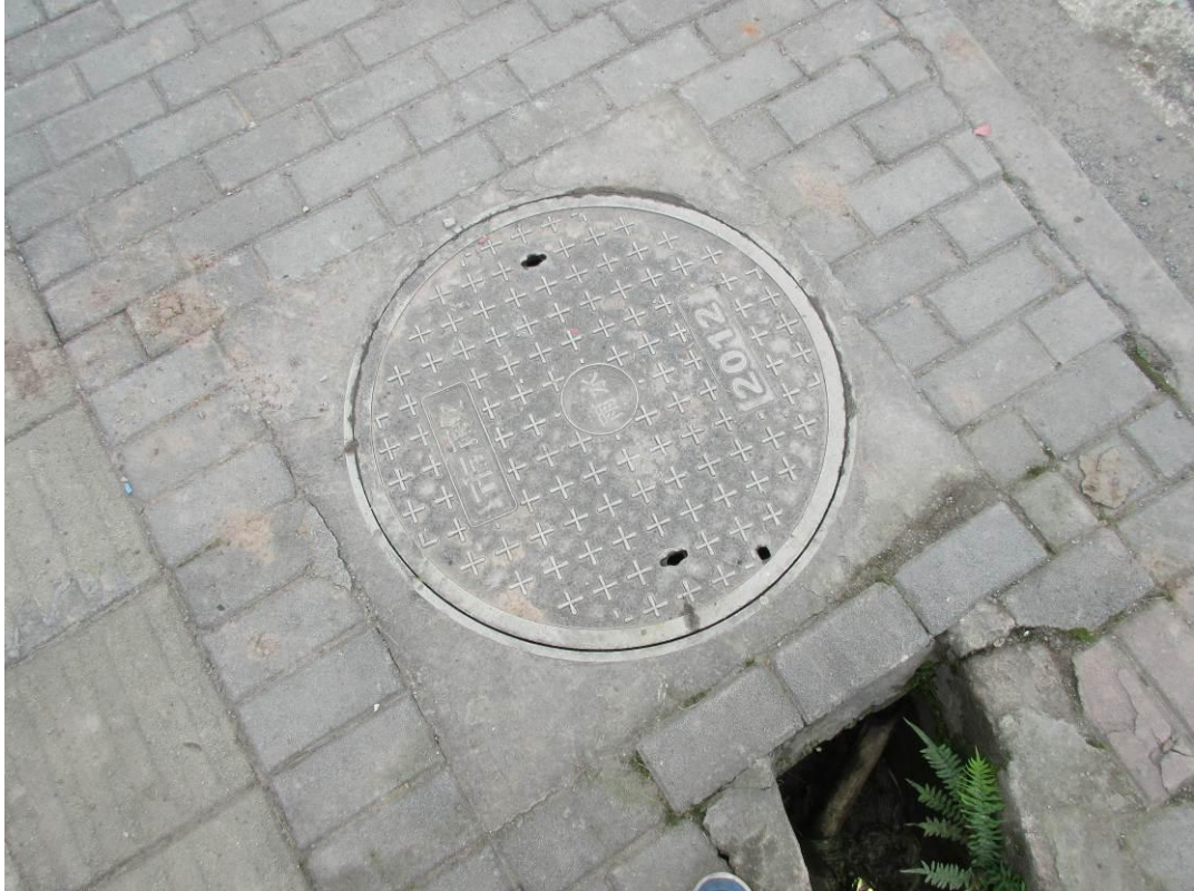
道路区雨水管网
